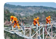
直流融冰： 操作复杂、能源损耗大
