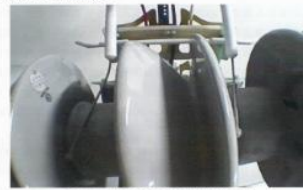
图9 577kV 电压下机器人实时检测的视频截图
