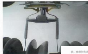
图10 635kV 电压下机器人实时检测
