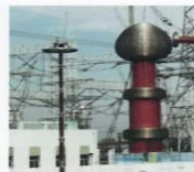
图1 1500kV工频试验
