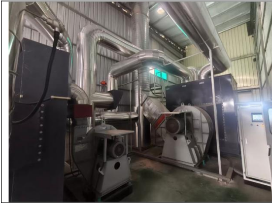
废气处理设施
