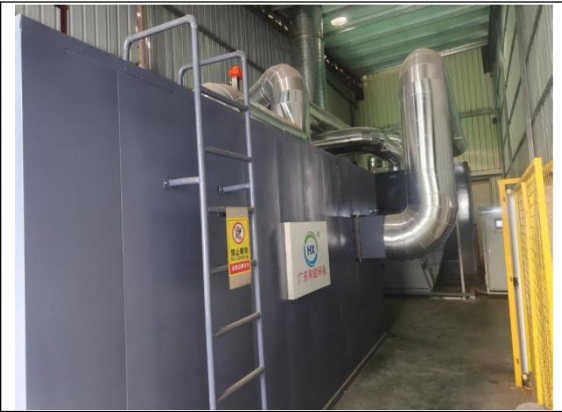
废气处理设施
