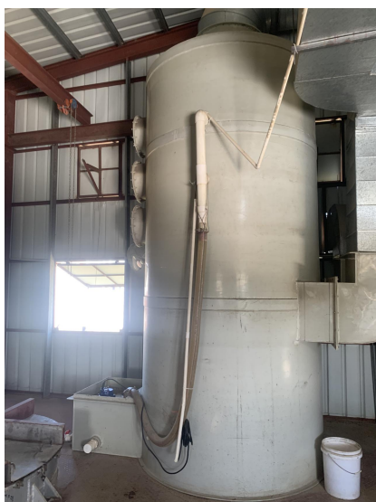
工艺废气处理设施（水喷淋）
