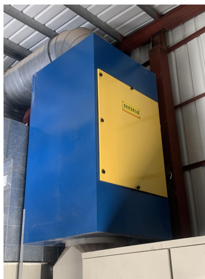
工艺废气处理设施（活性炭吸附）
