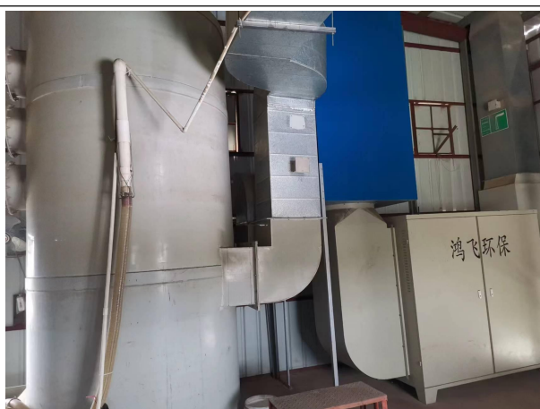
工艺废气处理设施（水喷淋+活性炭吸附+UV 光解）
