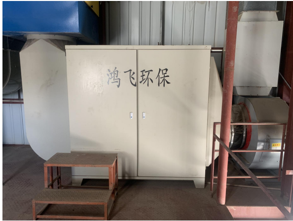
工艺废气处理设施（UV 光解）
