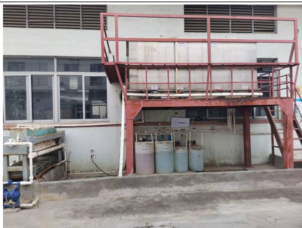
污水处理设施
