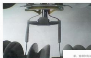
图10 635kV 电压下机器人实时回传的视频截图
